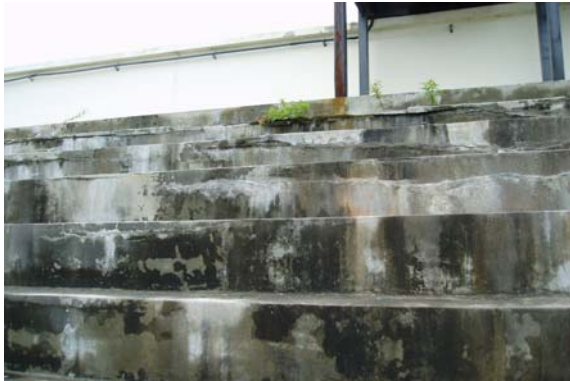
(a) 모르타르의 균열 및 누수
